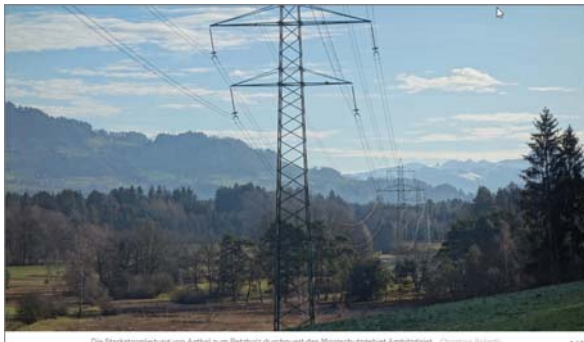
Die Starkstromleitung von Aathal zum Betzhof durchquert das Moorschutzgebiet Ambitzgriet.
